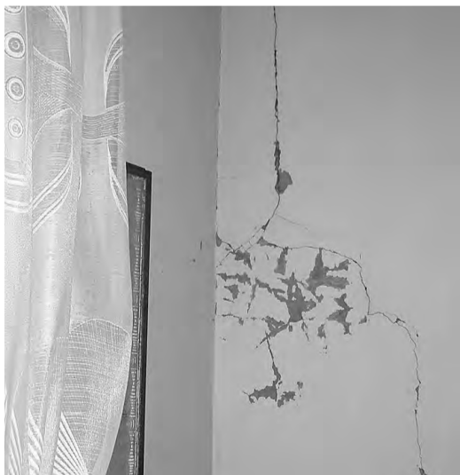
Parfois une simple alerte provoque des fissures qui peuvent présager des destructions plus graves.
