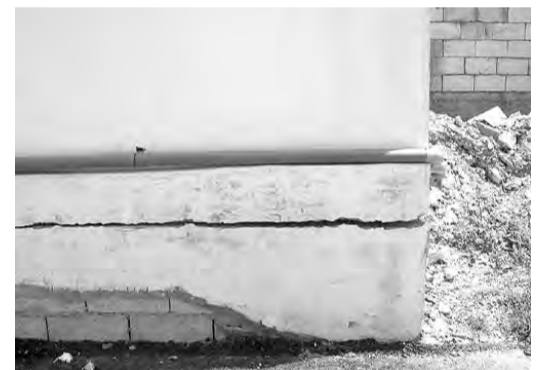
Même de faible amplitude, un séisme peut causer des dommages importants aux fondations d'immeuble.
