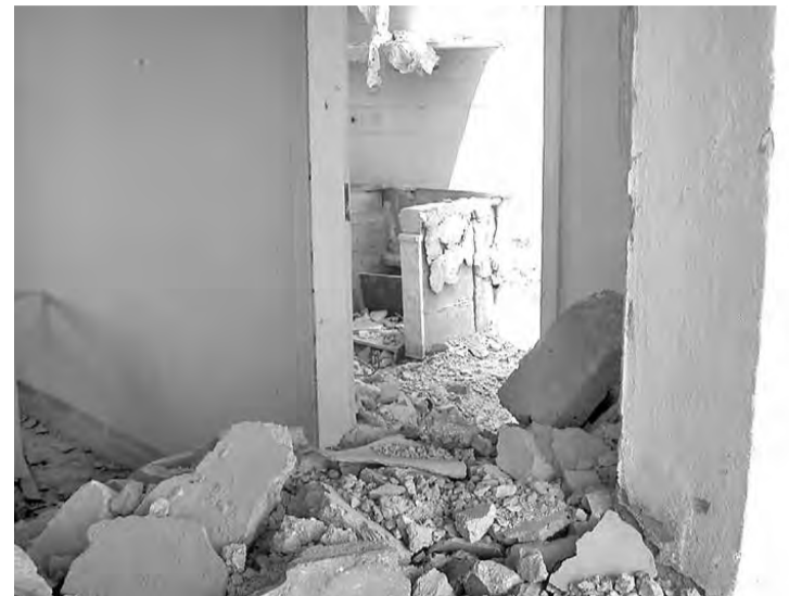
L'un des tremblements de terre avait occasionné des dégâts impressionnants dans certaines habitations au Liban-Sud.
